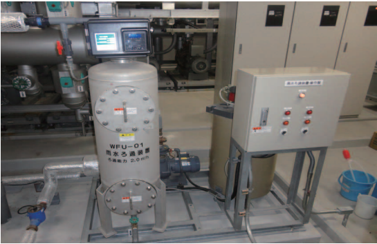
雨水ろ過装置
