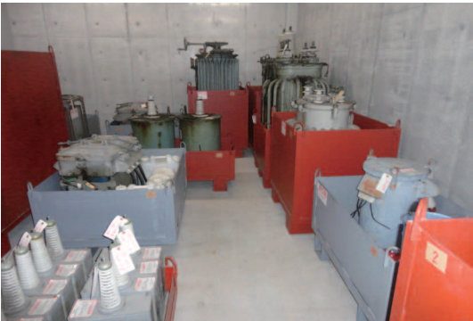
PCB 保管状況
