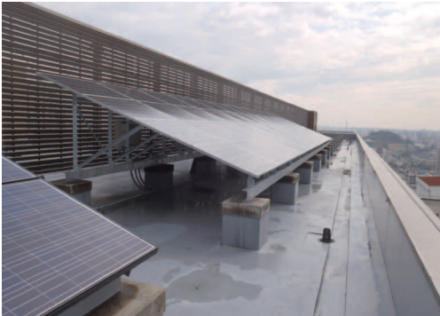
太陽光パネル
