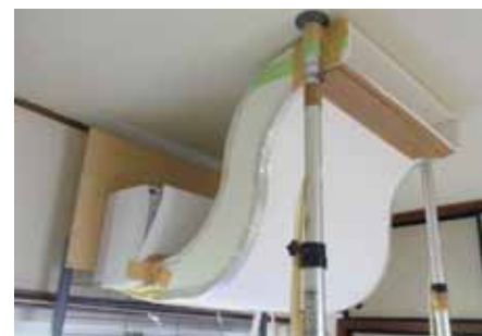
エアコンによる放射冷房
