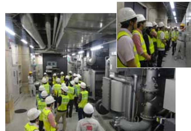
環境パトロールによる設備点検 (左) 冷温水発生機、(右上) 6,600V 変電設備
