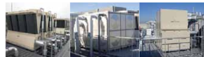
(左から) 電気ヒートポンプチャラー、氷蓄熱ユニット、水冷ヒートポンプチャラー
